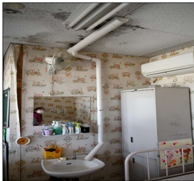
天井にカビ・雨漏りする医務室
